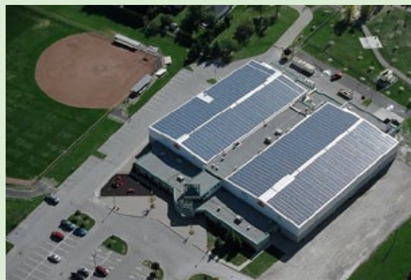
La TD a financé l'élaboration de l'un des plus vastes systèmes solaires photovoltaïques de toit au Canada.
